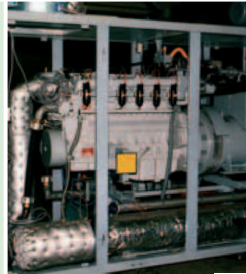
Bau und Planung von Blockheizkraftwerken für Industrie und gewerbliche Anwendungen
